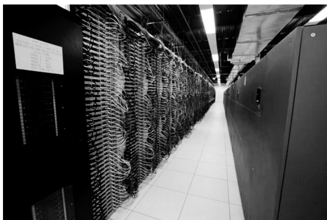
Rys. 5. Centrum danych firmy 1&1 w Kansas, USA
