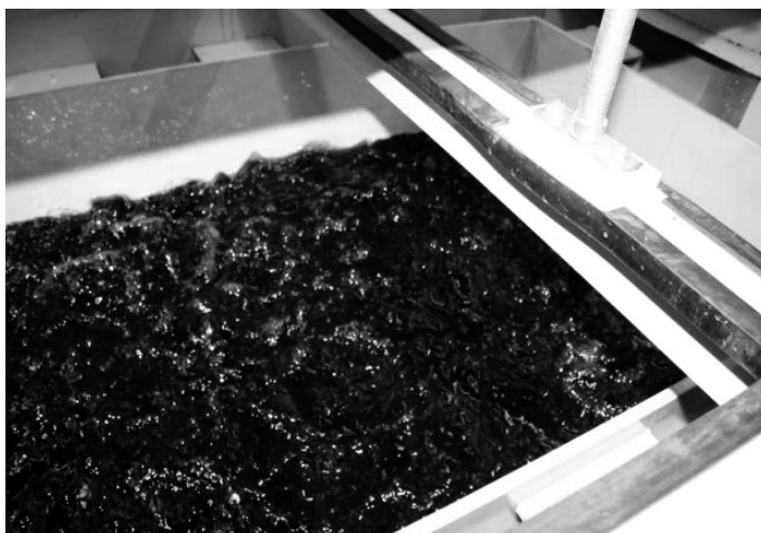
Rys. 2. Widok górnej części filtra w czasie płukania
