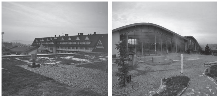
Rys. 5 i 6 Ekstensywny dach zielony na parku wodnym w Białce Tatrzańskiej Pic 5 and 6. Extensive green roof at the water park in Bialka Tatrzańska
