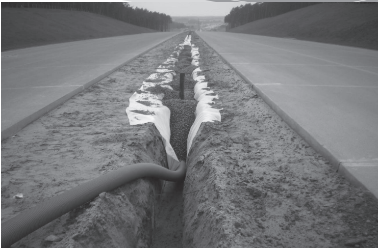
Odwodnienie w pasie rozdzielającym autostrada A2
