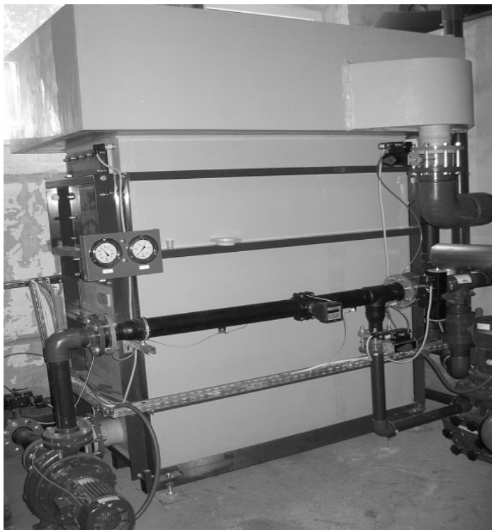
Rys. 1. Instalacja filtra podciśnieniowego (fotografia autorów)
