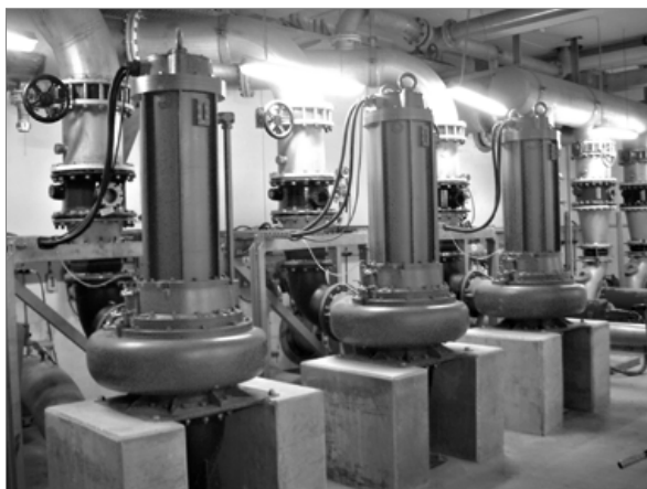
Fot. 7 Zastosowanie pomp ściekowych w suchej komorze
