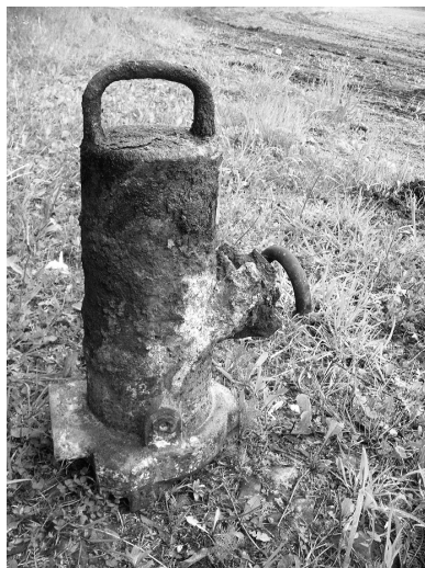
Fot. 5. Przykład wykonania pompy z nieodpowiedniego materiału w stosunku do składu tłoczonych ścieków
