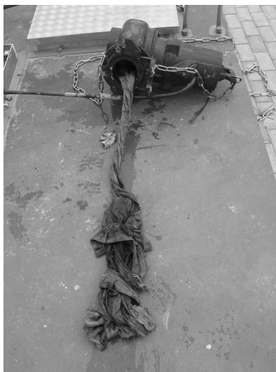
Fot. 6. Zatkany wirnik pompy ściekowej przez „szmatę”, która dołynęła do zbiornika pompowni.
