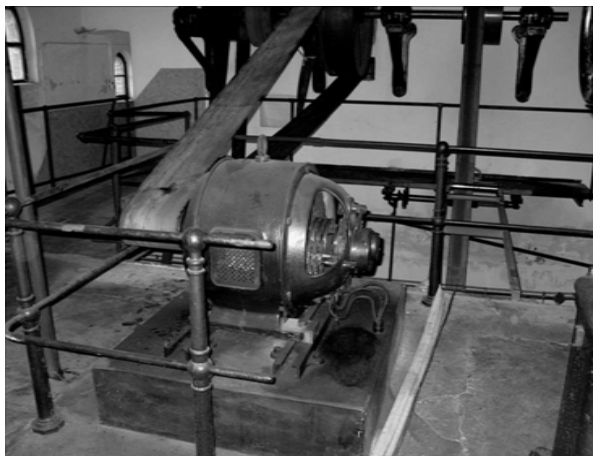
Fot. 2 Silnik napędowy agregatów pompowych
