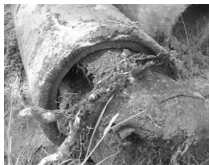
Rys.3. Zator spowodowany przez korzenie z pobliskich drzew, zmniejszenie średnicy przewodu o 98 %
