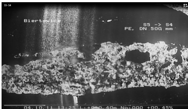
Rys. 1. Osad przyczepiony do ścian kanału, tłuszcze, redukcja średnicy o ok. 5%
